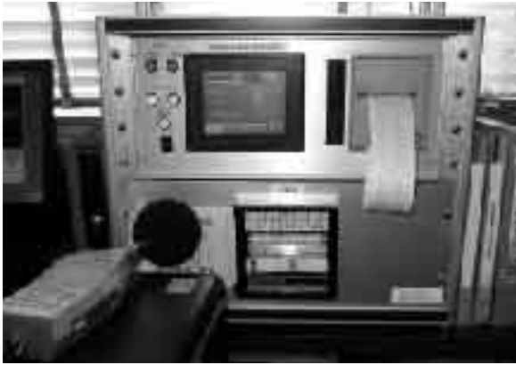
騒音計を利用した自動通報システム
