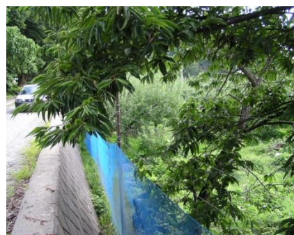
③侵入防止柵の上部にかかる枝
