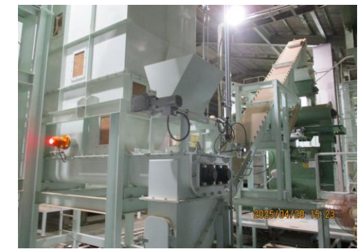
上伊那森林組合 木質バイオマスエネルギー工場内
