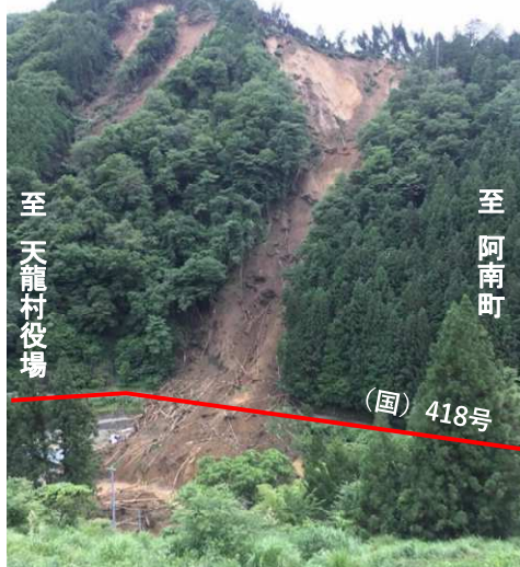
被災後状況写真(天龍村)
