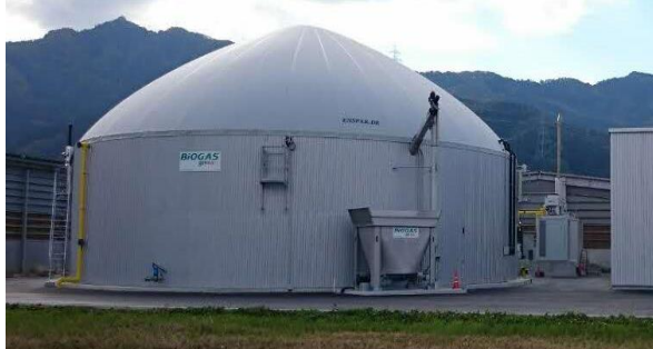
バイオマスガス発電所（中野市）
