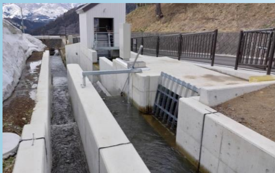
ヘッドタンク (取水除塵施設)
