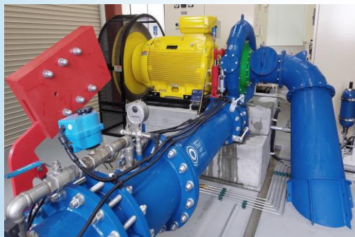
水車発電機 (発電施設内)
