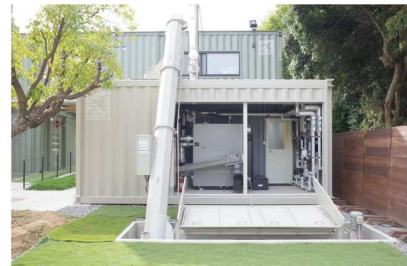
130kW級バイオマスボイラーユニット (ボイラー庫、チップ庫が一体型)
