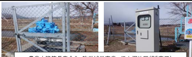
農業水路等長寿命化・防災減災事業 行人塚地区(R5完了) 自動化された放水ゲートと操作盤
