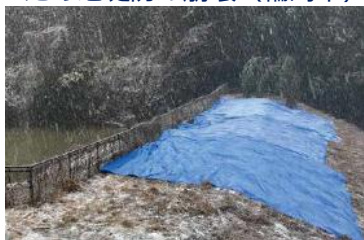
ため池堤防の崩壊（輪島市）
