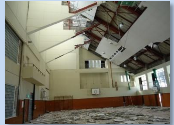
避難所における天井落下の事例 (長野県北部地震)
