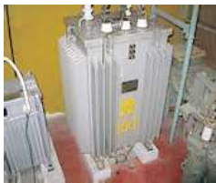
変圧器 (トランス)
