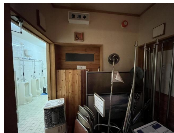
使用されていないトイレ
