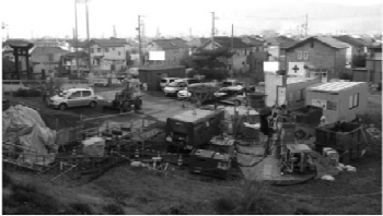
実際に設置したプラント
