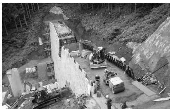
写真 9-4-12 砂防ソイルセメント砂防堰堤
