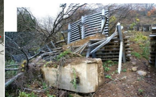
土砂とともに雪崩防止柵が流下し、下部柵に乗り上げてしまっている。
