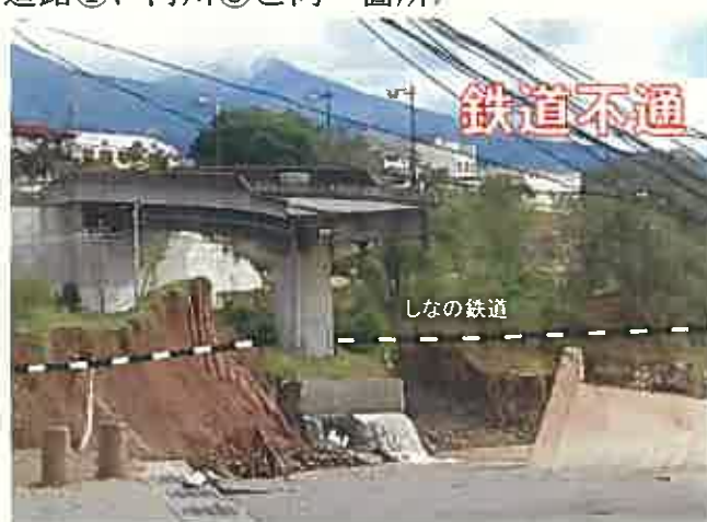
被災した橋梁下のしなの鉄道線
