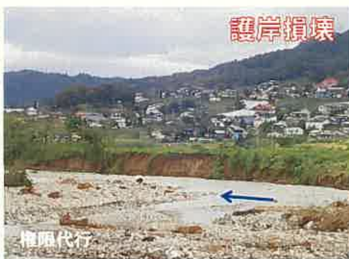
左右岸護岸損壊 上流 床止工被災
