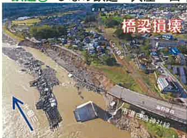
道路橋の損壊によりしなの鉄道が不通
