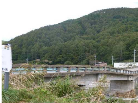
台風 19 号により橋脚が破損したため、早期の対策により、道路交通の確保を図ります。
