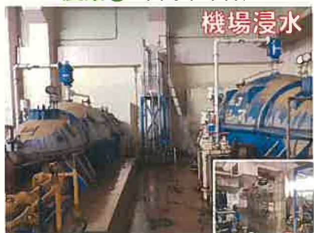
排水機場が浸水し稼働不能
