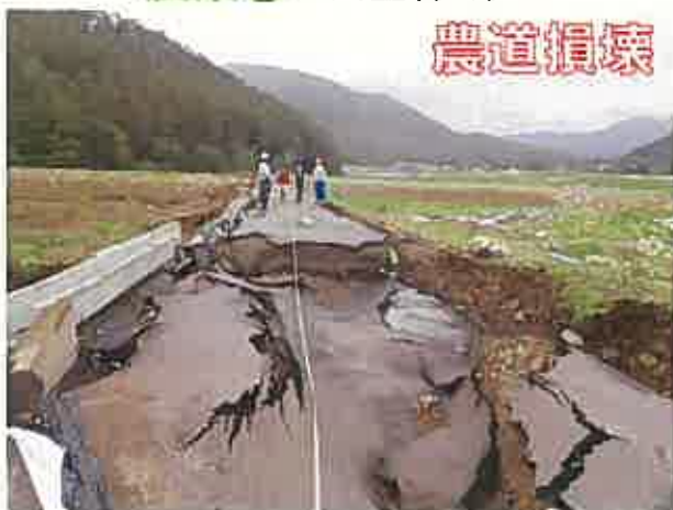
農道が損壊し通行不能
