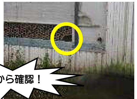
家きん舎側面の金網の破損
