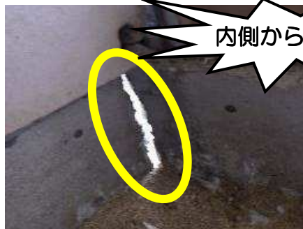
家きん舎の基礎部分にヒビ割れ
