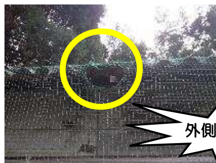
家きん舎側面の防鳥ネットの破損
