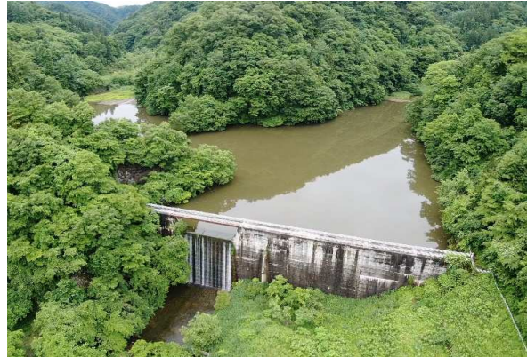
大型砂防堰堤パトロール (大町市美麻 片岡堰堤 H=20m R4年6月 ドローンで撮影)
