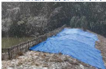
ため池堤防の崩壊（輪島市）
