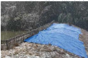
ため池堤防の崩壊（輪島市）
