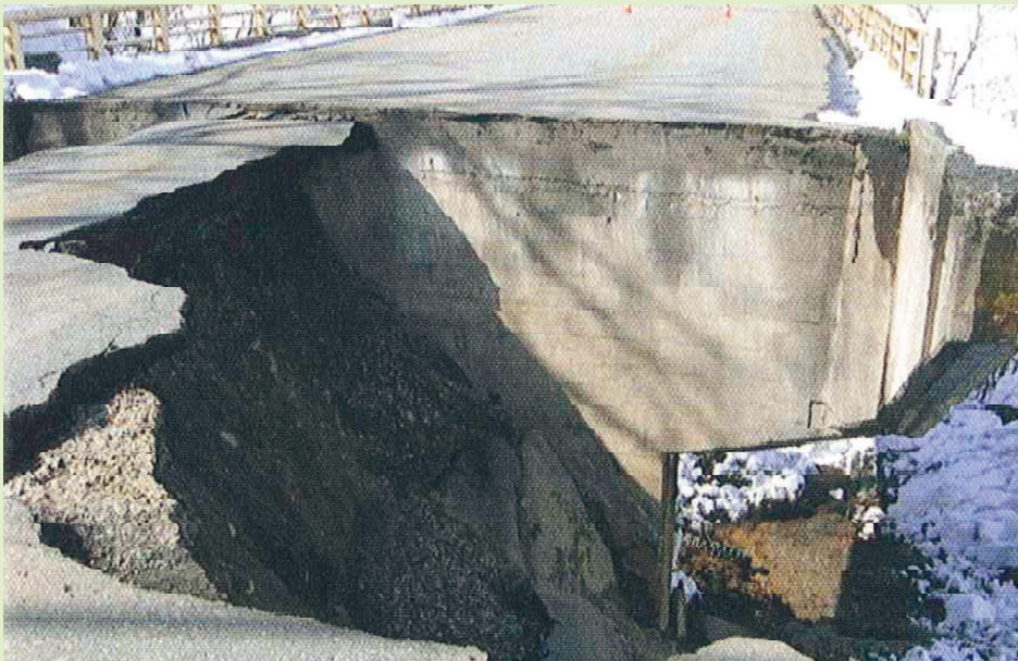
ながのけんほくぶ じしん どうろ 長野県北部の地震で道路がくずれた様子。
