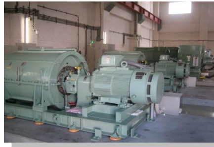
ブローラ棟送風機の全景
