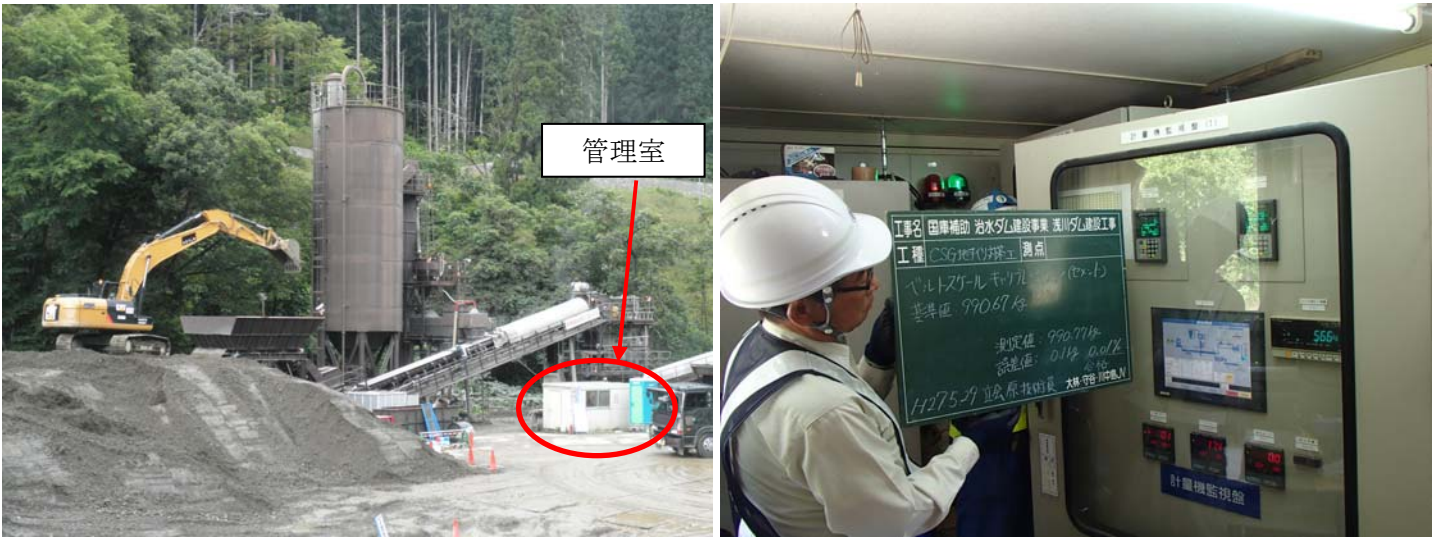
写真 3.6.7 CSG 混合機全景（管理室）
