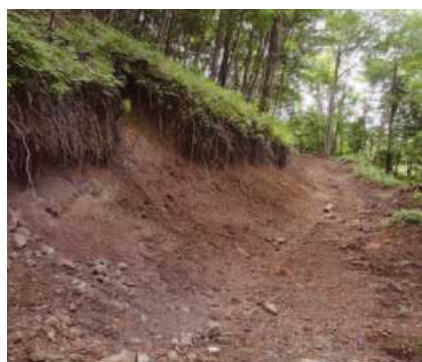
【写真Ⅱ】地山を切っただけの作業路は崩れやすい
