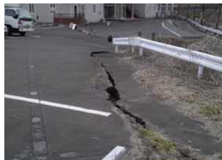
(b)のり肩の亀裂
