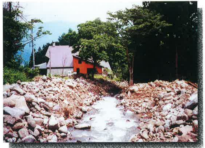
④ 被災状況 (H7.7)
