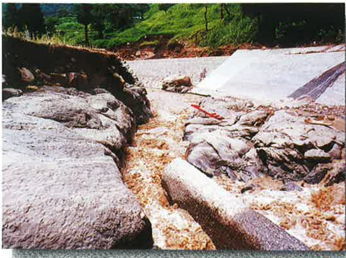
③ 護岸が決壊し田畑が流出した(H7.7)
