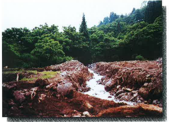
② 被災状況 (H7.7)
