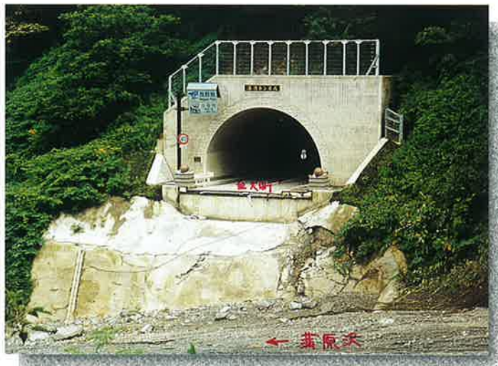
④被災状況 (H7.7)
