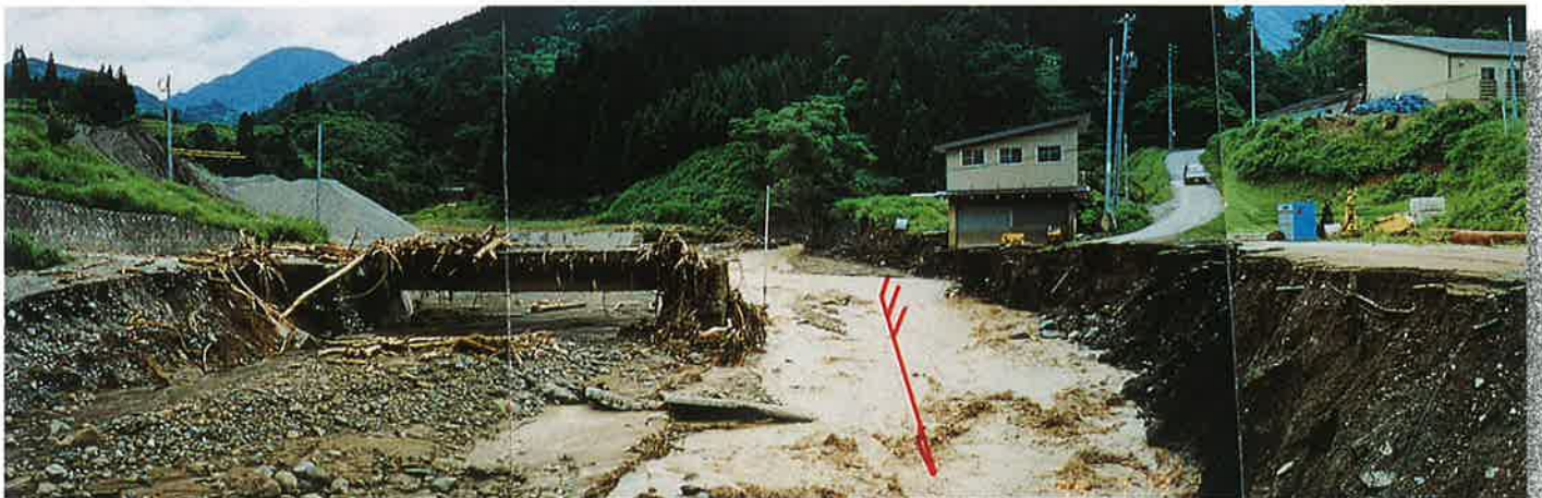
② 川が橋の裏を流れ村道が寸断された
