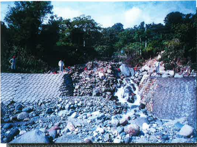
① 被災状況 (H7.7)
