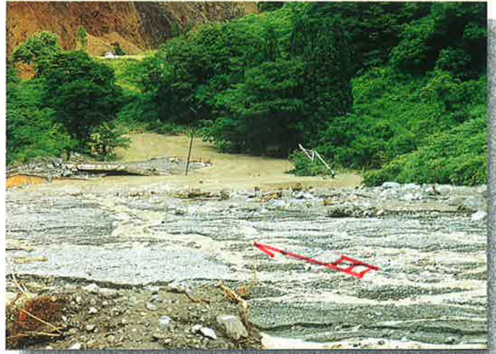
②被災状況 (H7.7)
