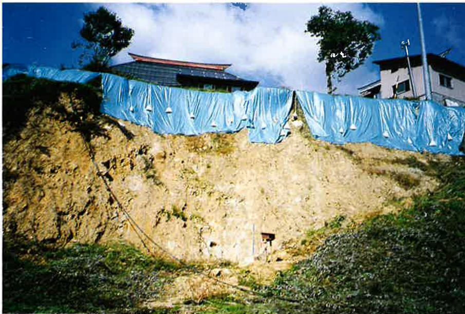
人家のすぐ下で地すべりが発生した
