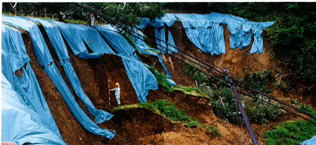
地すべり直後の生々しい滑落崖と応急対策のシート
