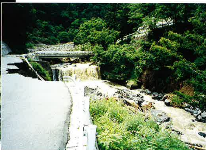
道路路肩欠壊状況
