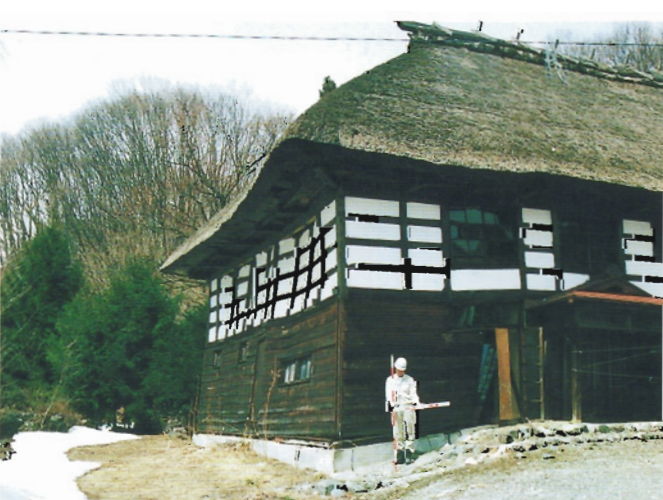
③ 保存家屋の変状と40cmの段差
