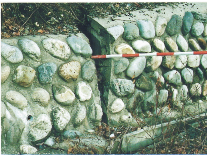
① Aブロック末端部の高水位護岸擁壁の変状
