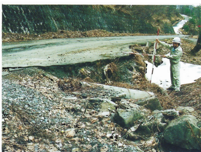
⑤ Aブロック頭部の村道に現れた120cmの段差
