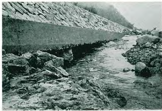
本谷川河床洗掘状況
