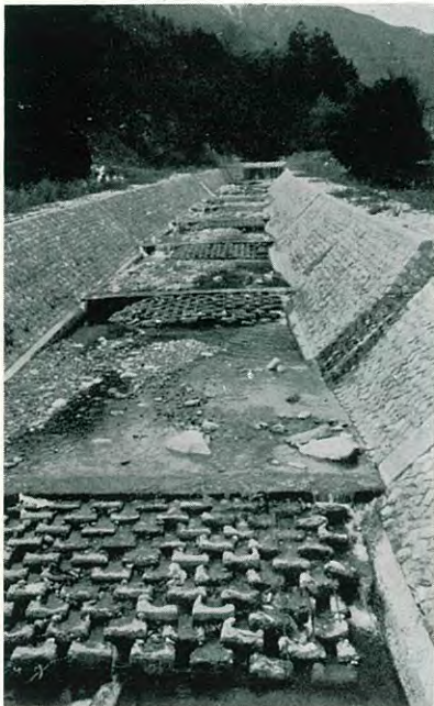
小型ブロックの破損状況 (横川川)
