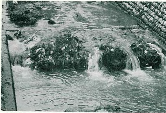
フトン籠破損状況 (野底川)
