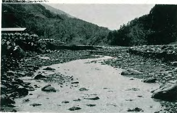
河床洗堀状況
