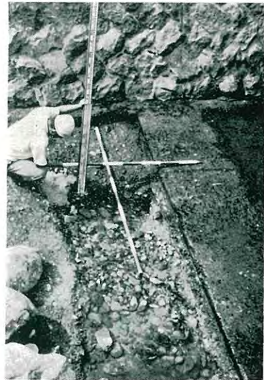
底張工洗掘状況
