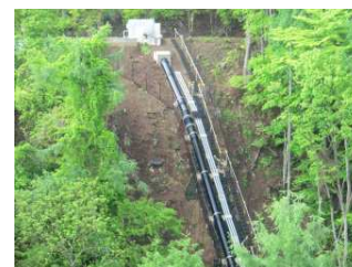
【小水力発電施設】
