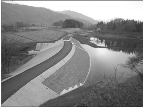
【堤体の改修により安全性が向上したため池】 (農村地域防災減災事業 岡山地区)
