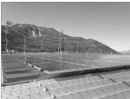
【貯水槽の屋根に設置された太陽光パネル】 (県営かんがい排水事業 大深山地区)
