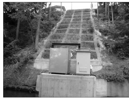
【稼働開始した小水力発電施設】 (県営かんがい排水事業 波田堰地区)
