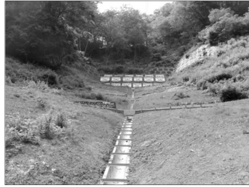
【アンカー工等の整備により地すべりを未然に防止】 (地すべり対策事業 八坂地区)
