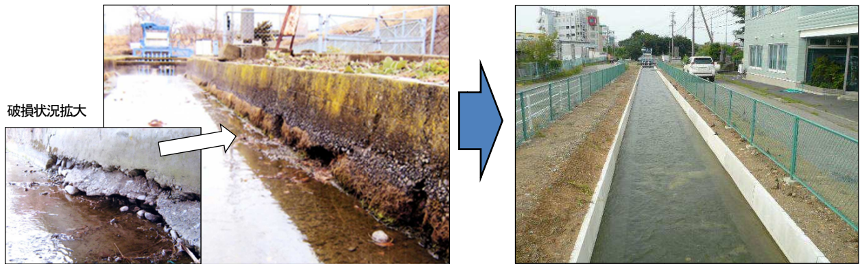
【更新前：農業用水の安定供給に支障】
