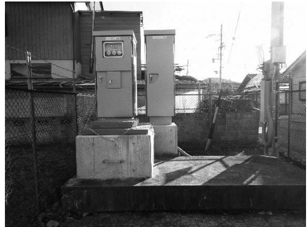
四ツ屋2号井戸ポンプ場浸水対策
