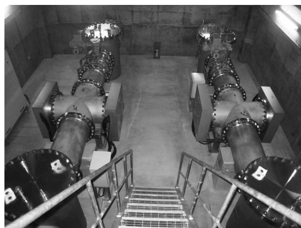
完成した紫外線処理設備
