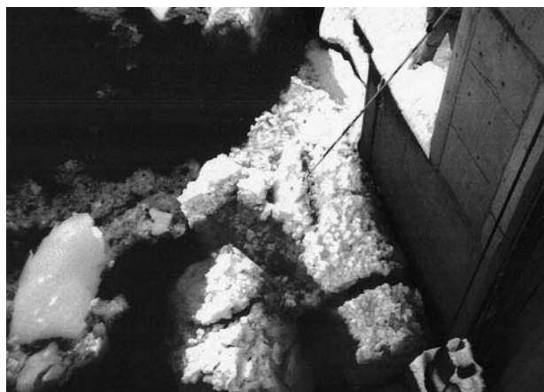
大雪による取水口閉塞
