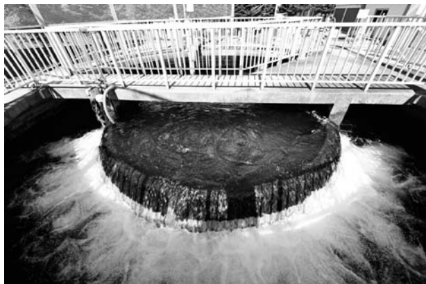
本山浄水場の着水井
