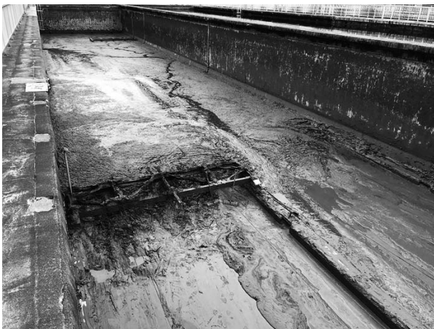
令和2年7月豪雨後 沈殿池
