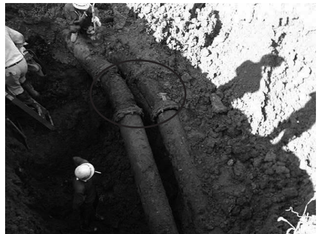
送水管・配水管の漏水箇所
