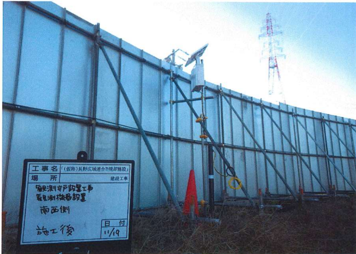
地下水水質・水位測定用井戸 設置状況①(南西側)
