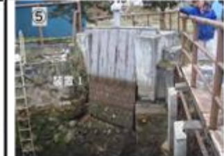
御小屋用水路 装置 1, 2, 3(スクリーン)
