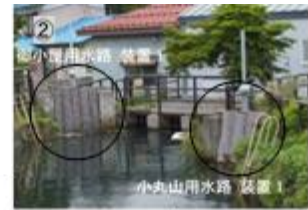
池尻川からの取水口
