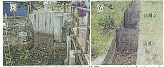
御小屋用水路 装置 1、2、3 (スクリーン)
