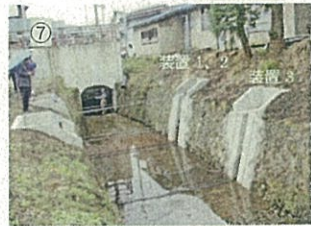
池尻川 装置 1、2、3 (ネット)
