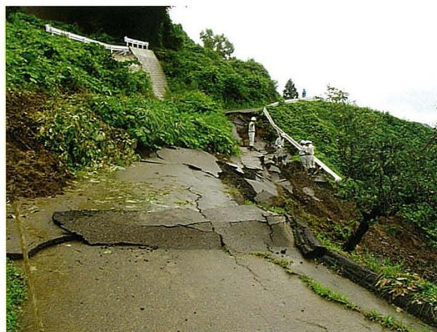
通行不能となった村道
