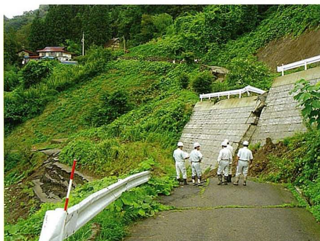
破壊されたコンクリートブロック積
