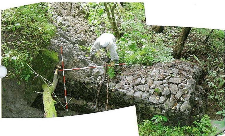
押し出しにより変形した床固工
