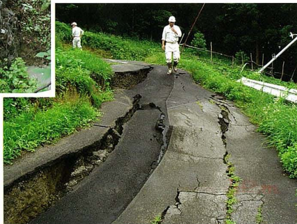
通行不能となった農道
