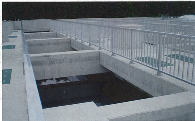
第5系列 最終沈殿池
