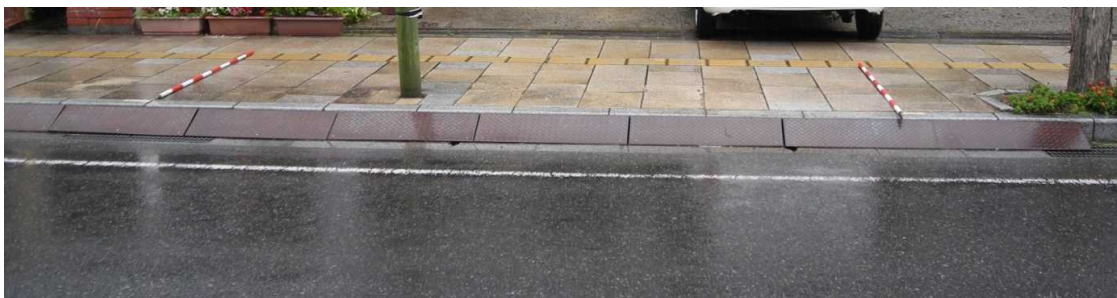
段差解消構造物設置：危険な状況
