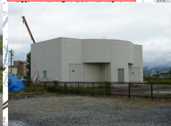
沖雨水ポンプ場(3.66m 3 /s)
