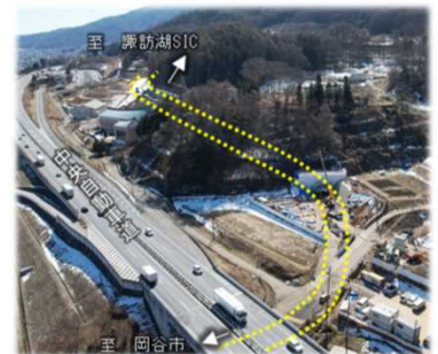
(主)諏訪辰野線 岡谷市～諏訪市 小坂～有賀 (平山トンネル施工状況)
