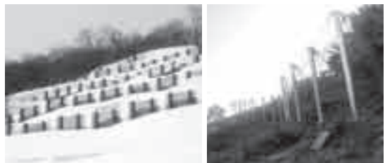
スキー場上部に設置した雪崩予防柵
