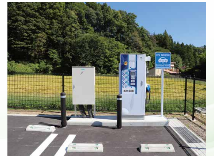
西天竜発電所に整備されたEV急速充電器
