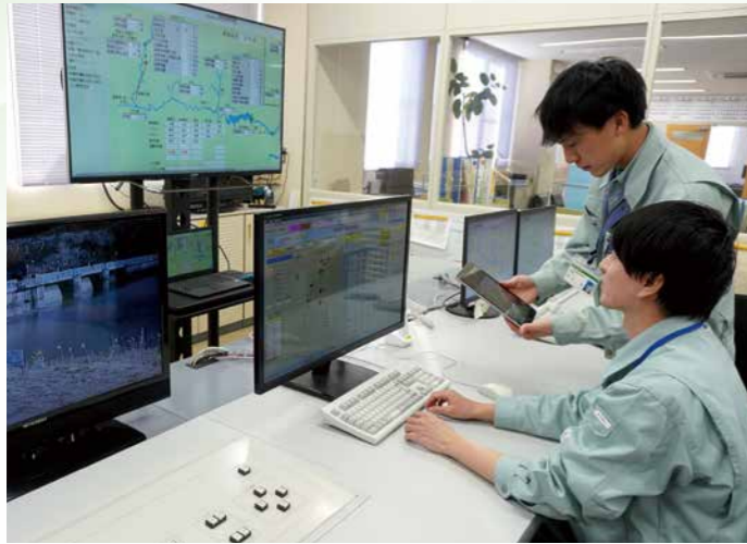
中央制御所での監視制御
