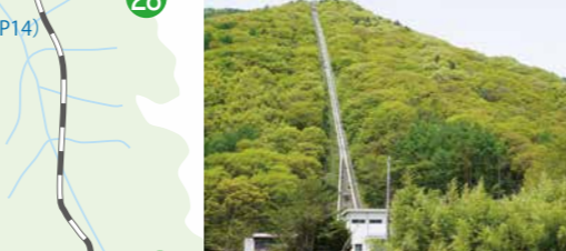
菅平発電所 (北信発電管理事務所管内)
