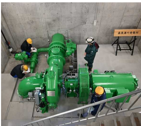
水車発電機の試運転状況 (R6.2)
