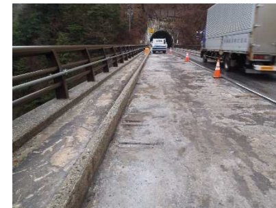
対策前: 損傷状況
