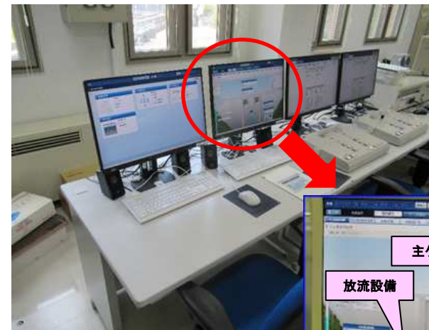
管理用制御設備更新後
