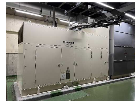
非常用発電設備の整備イメージ
