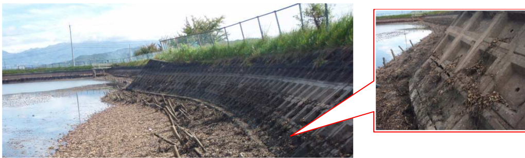
ため池の老朽化が進み、波除護岸にクラックが発生している。
