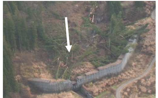
神城断層地震発生時に流出した土砂を捉えた砂防堰堤（平成26年小谷村カクレ沢）
