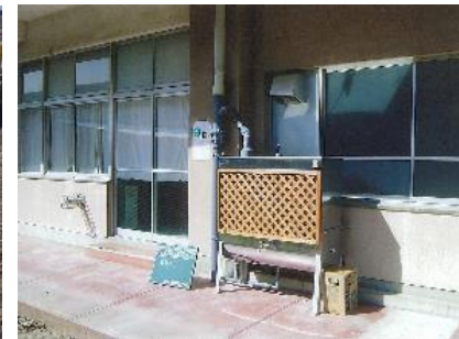
雨水貯留タンク 設置例
