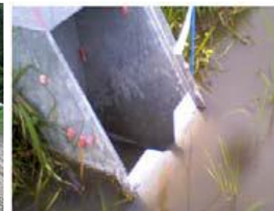
水田排水口の 調整装置設置例
